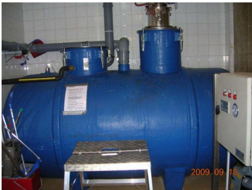
Figur 18. Tank till köksavfallskvarn i storkök. Tanken är placerad i ett utrymme skilt från köket. Foto: Linda Irebrand
