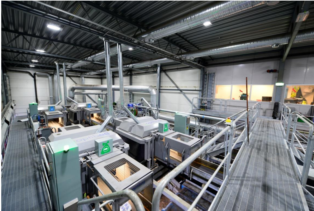
Figur 8. Interiör i optisk sorteringsanläggning i Skien, Norge. Foto: © Envac Optibag
