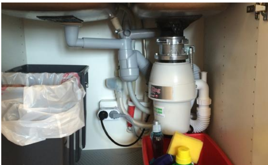
Figur 14. Köksavfallskvarn installerad under diskbänk i hushåll. Foto: Stockholm Vatten och Avfall
